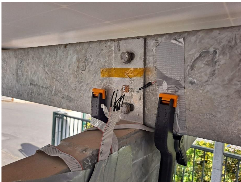
Piezoeléctrico instalado en la marquesina de la empresa colaboradora.
